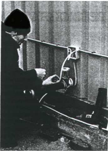
Na zdjęciach pokazano przykład zabezpieczenia zbiornika przeciwpożarowego (Ford Poland w Płońsku) przed zamarzaniem
